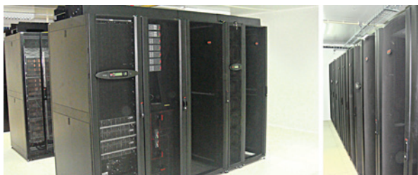
Data Center da Ferrovia
